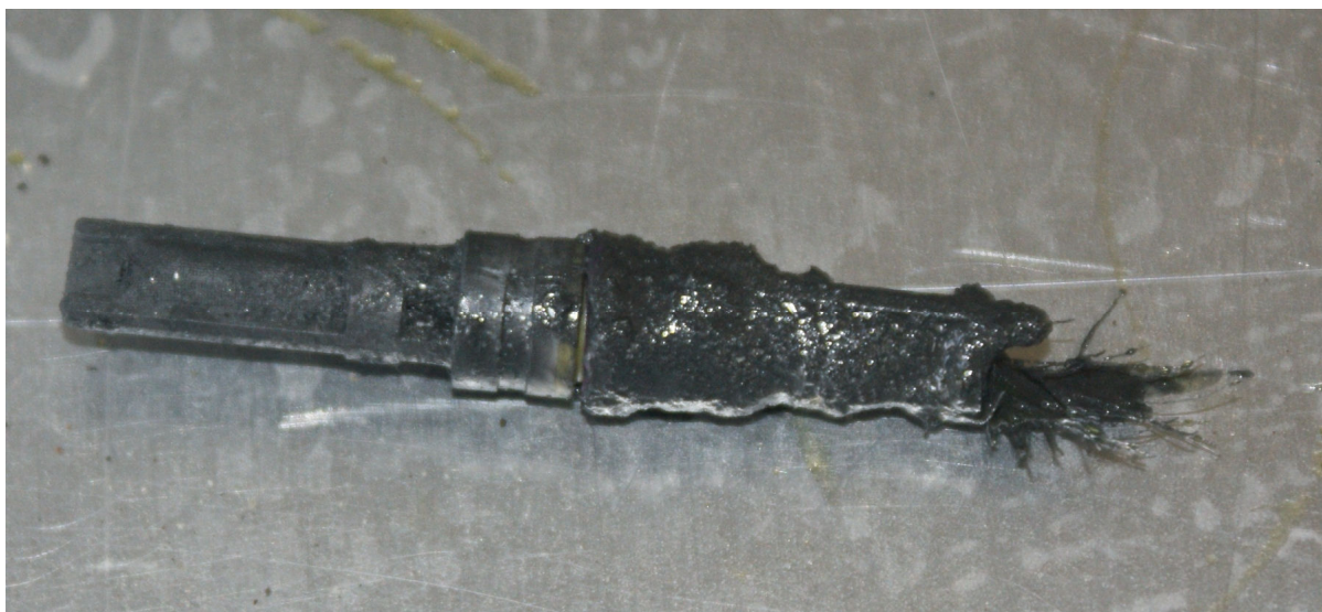
Rys. Dysza dławiąca zaklejona cząstkami rozpadu oleju, cząstkami zużycia uszczelnień oraz drobinami metalowymi. Wnętrze instalacji klimatyzatora wygląda w ten sposób po ok. 10 latach pracy
